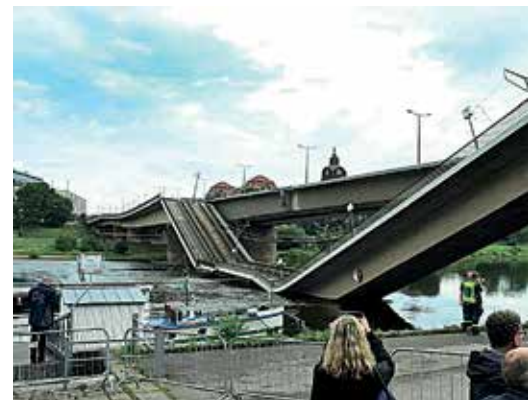
Einsturz der Carola-Brücke in Dresden
