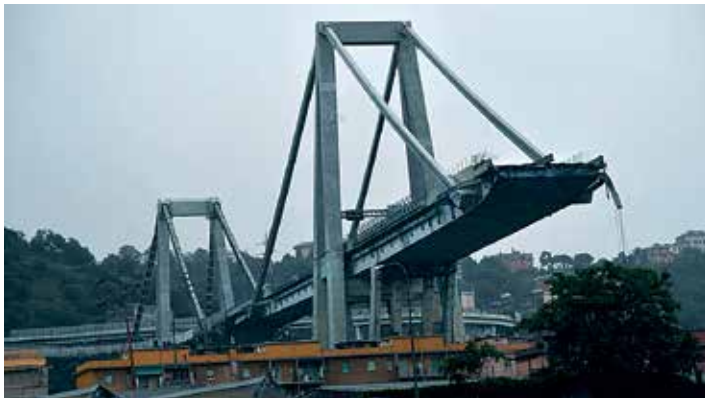
Brückeneinsturz in Genua
